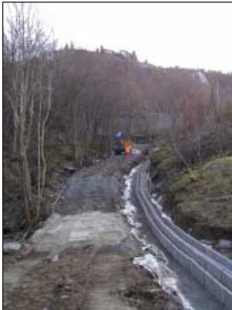
Figur 2: Ved legging av kabelanlegg i områder fri for tekniske inngrep, vil man få en anleggsveg ved siden av kabelgrøften. Bildet viser kabelgrøft for en 132 kV kabel med to kabelsett. (Foto: BKK)
