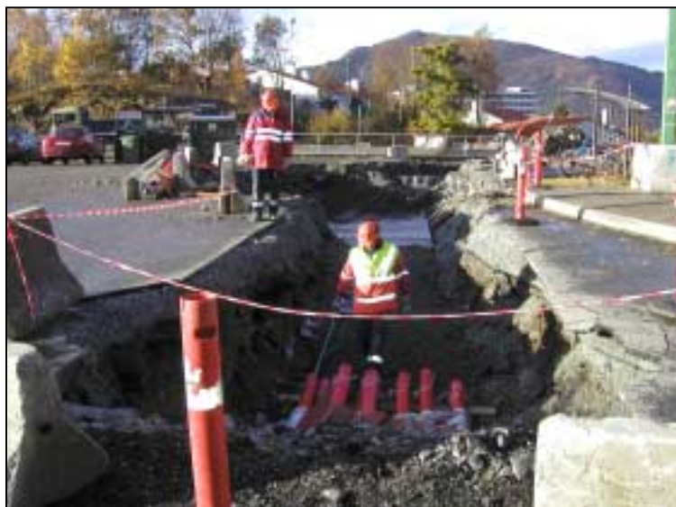
Figur 5.9: For kabelanlegg i tett befolkede områder med mye eksisterende infrastruktur vil entreprenørarbeidene være en stor del av totalkostnaden. (Foto: BKK)
